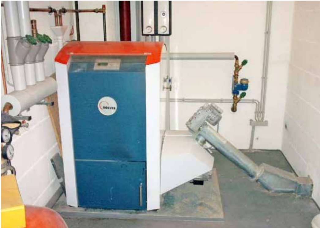
Holzpellet-Heizung im LVR-Freilichtmuseum Lindlar
